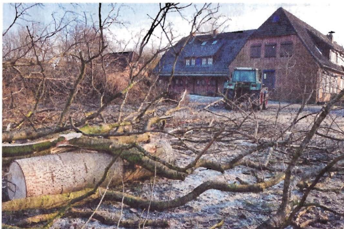
Die Reste des früheren Schulwaldes wurden entfernt, so dass an dieser Stelle nun mit dem Bau des Dorfgemeinschaftshauses begonnen werden kann. SILKE SCHLÜTER
