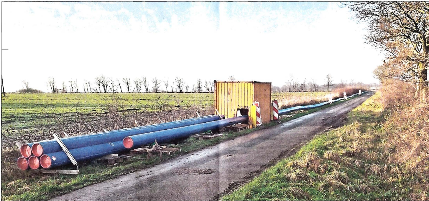
Das aus mehreren Segmenten zu einem mehr als 400 Meter langen Strang zusammengesetzte Rohr wiegt mehr als 10 Tonnen. Foto: WV Nord
