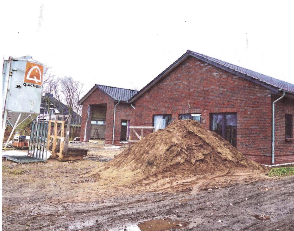
Für das im Bau befindliche Gemeinschaftshaus – eine Kombination aus Dörpshus und Feuerwehrgerätehaus – gibt es 187.500 Euro an Zuwendungen vom Land.
